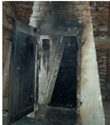
Abb. 3.4.7/3: Räucherkammer integriert in den Schornstein. (Foto: Volker Wendel, Wendel-Schornsteintechnik GmbH, Herrstein)
