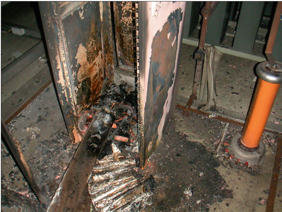
Abb. 4: Ausgebrannte 80-kV-Funkenstrecke (Quelle: Dr. Holger de Vries)
