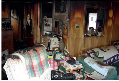
Abb. 7: Brandraum mit intensiver thermischer Aufbereitung ohne flammende Verbrennung; die angekohlten Gegenstände haben massiv Pyrolysegase freigesetzt, die sich jedoch aufgrund unzureichenden Sauerstoffangebots nicht entzündeten (Foto: Gresham, Fire & Emergency Services)
