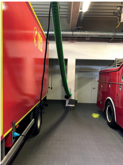
Abb. 51: Unkorrekt aufgesetzte Quellenabsaugung (Quelle: Marcus Bätge)
