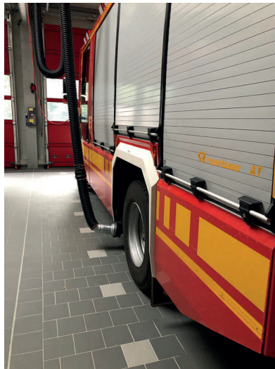
Abb. 52: korrekt aufgesetzte Quellenabsaugung (Quelle: Marcus Bätge)
