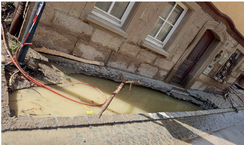
Abb. 11: Von einer Prallwelle betroffene Hauswand (Foto: THW OV Crailsheim)
