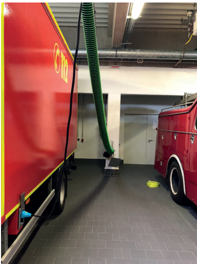
Abb. 51: Unkorrekt aufgesetzte Quellenabsaugung (Quelle: Marcus Bätge)
