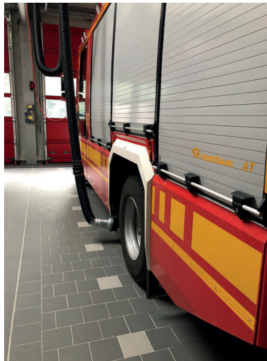
Abb. 52: korrekt aufgesetzte Quellenabsaugung (Quelle: Marcus Bätge)
